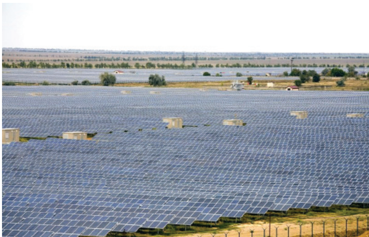
Крымская СЭС «Перово» мощностью 105 МВт, была одной из крупнейших в мире
