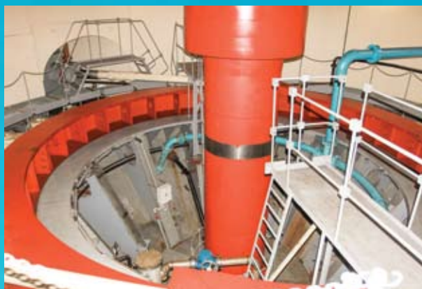
Агрегат Рыбинской ГЭС
