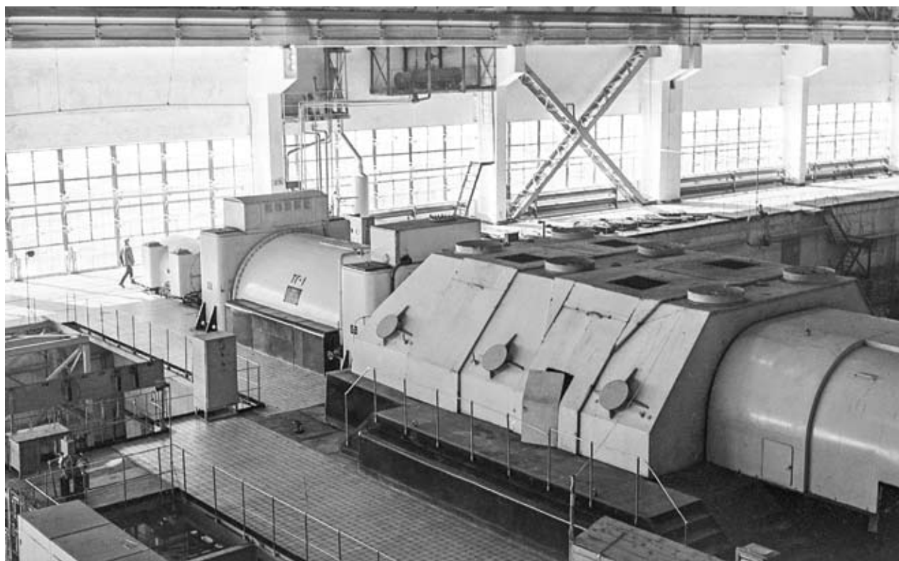
Конаковская ГРЭС. Турбина в 300 МВт. 1966 год
