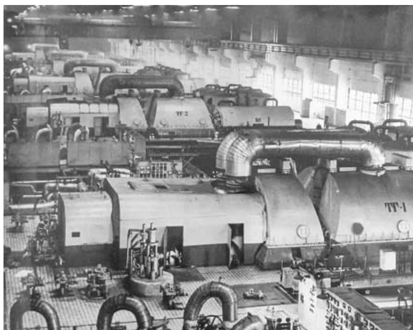
Общий вид машинного зала Новочеркасской ГРЭС. 1970 год
