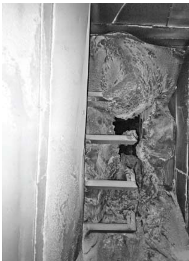
Отложения золы в трубе Вентури на Благовещенской ТЭЦ. 21 марта 2001 года
