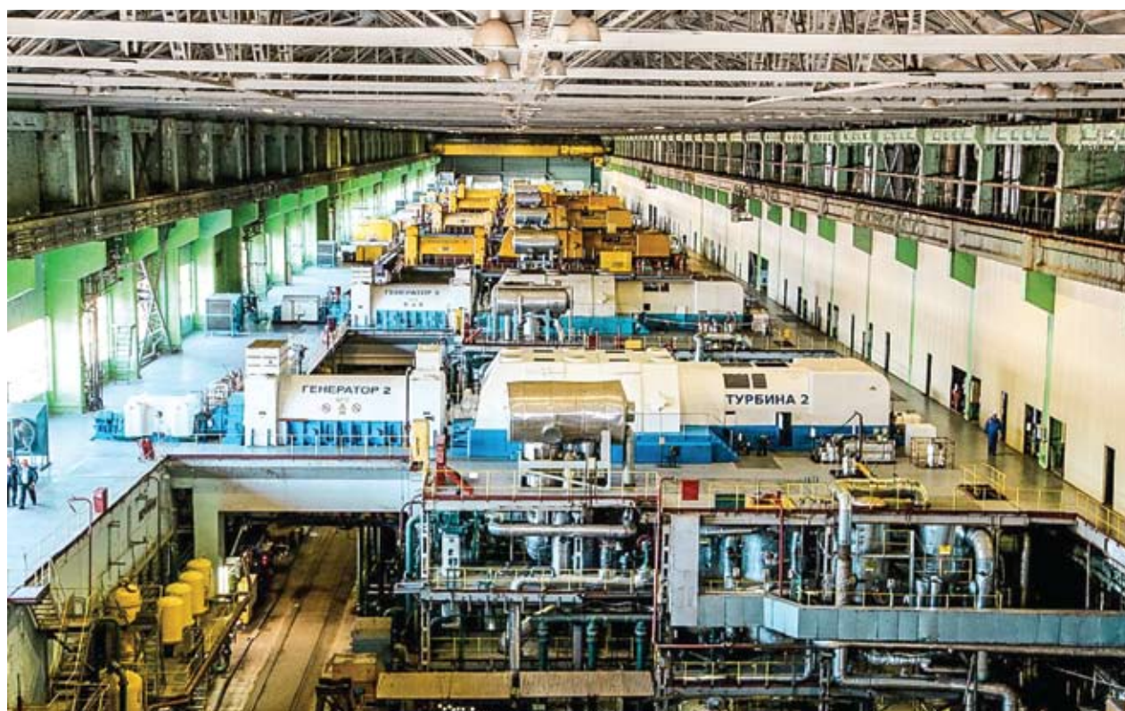
Машинный зал Конаковская ГРЭС
